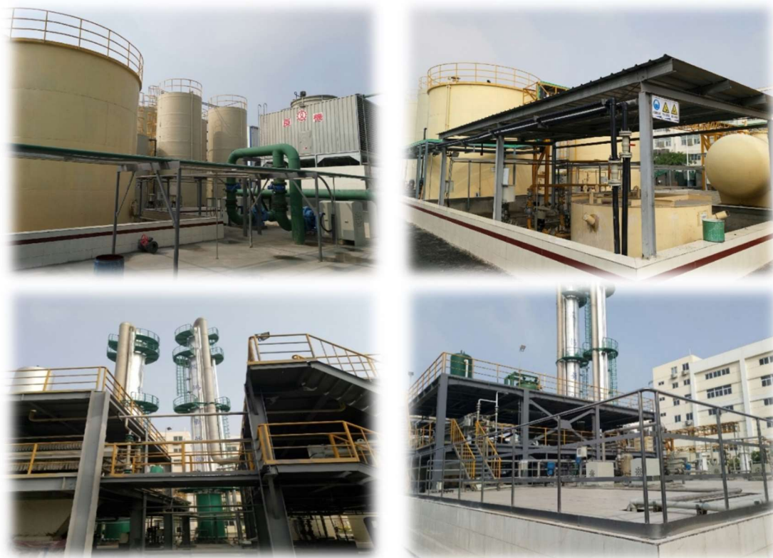
图：1800 吨/天含氨废水资源化综合处理项目
