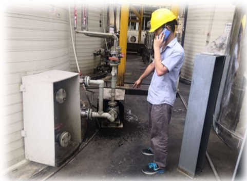
巡检时发现液碱管道泄漏及时上报
